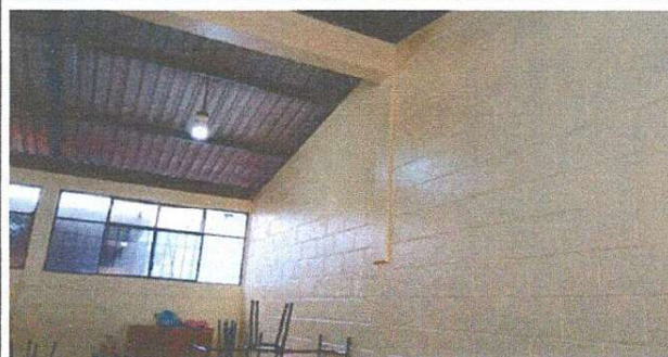
Foto 4: Pintado de pared e instalacion electrica dañada, de en cuatro aulas culminadas.
